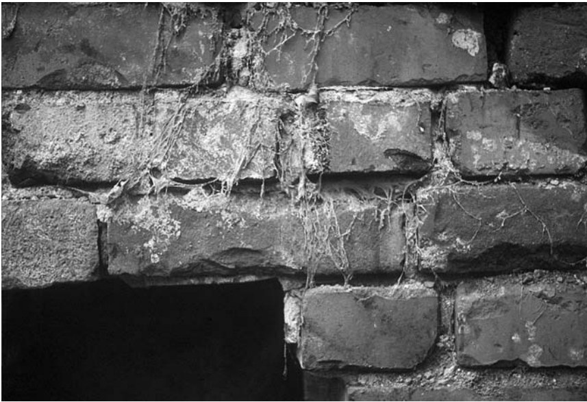
Tiilimuurauksissa tämä surkea näky on tavallinen. Lattiasienen rihmastojänteet ovat läpäisseet seinän, ja rihmaston lahotustyö on jatkunut seinän toisella puolella.
